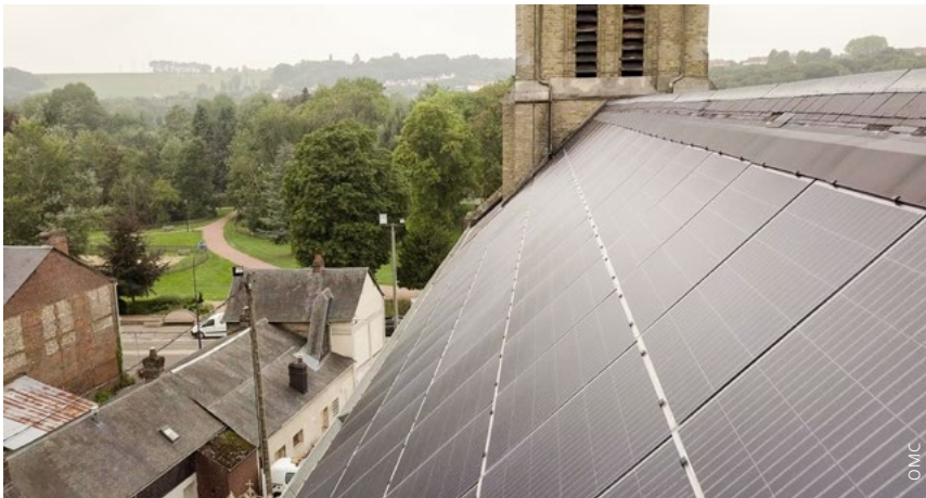
Vu de l'une des neuf toitures solaires installées sur la commune de Malaunay (Seine-Maritime), qui produisent environ 250 MWh par an.
