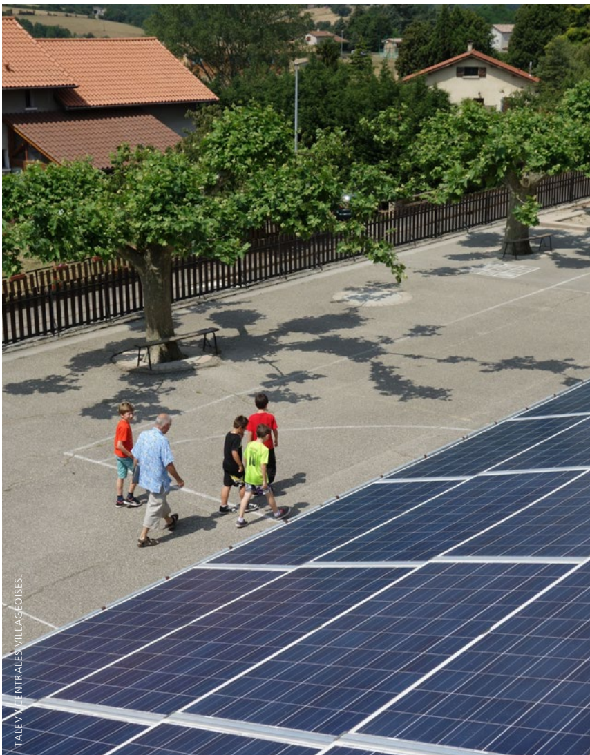
Centrale villageoise de la région de Condrieu. Partie installée sur l'école de la commune des Haies.
